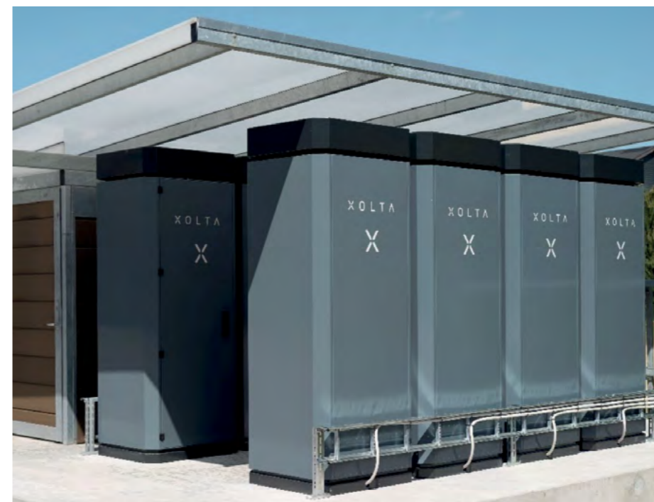
Figur 13: Haarups maskinfabrik ved Silkeborg har monteret 12 XOLTA-batterier, der lagrer el fra fabrikens solceller og gør fabrikken selvforsynende med elektricitet fra marts til november [53].
