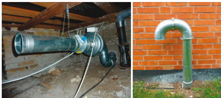
Figur 8. Udsugning fra krybekælder med afkast til det fri.
