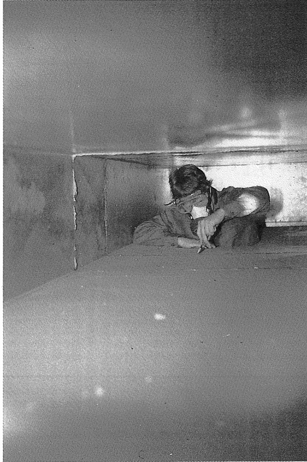
Figur 3. Størstedelen af støvet i de vandrette kanaler sad på bundfladen.
