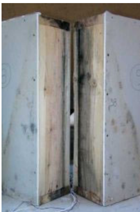
Figur 33. Eksempel på opfugtning af konstruktionstræet omkring en fuge. Billedet, der er fra samlingen ved detalje 2, er taget ved nedtagningen af elementerne. Gipspladen sidder på den indvendige, varme side af konstruktionen.
