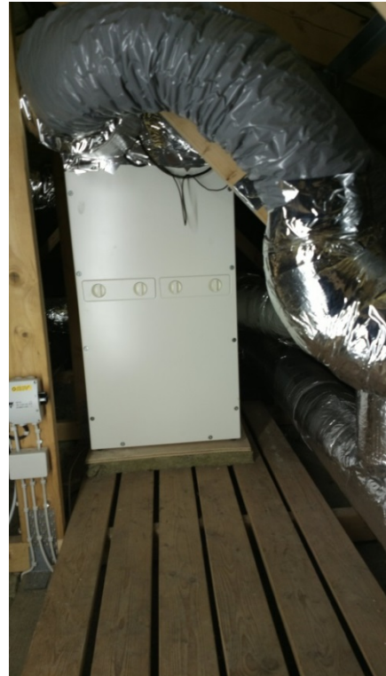
Foto 25 Nyt ventilationssystem med varmegenindvinding på loftet. Græsvangen
