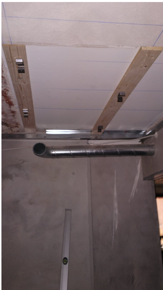
Foto 18 Ny ventilation (indblæsning) udmunder i stue ) Jyllandsgade
