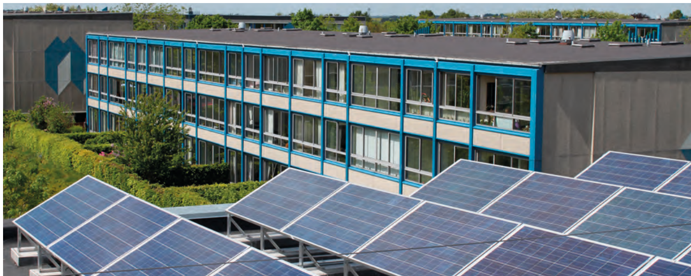
Solceller og solfangere på Klimablokken.
