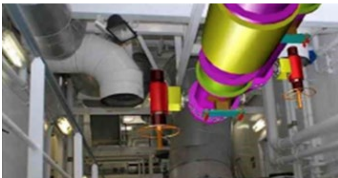
FIGUR 38. Augmented Reality (AR) indlagt som 3D-model i den eksisterende VVS-installation. Kilde Kjeld Svidt, AAU BUILD i Aalborg.
