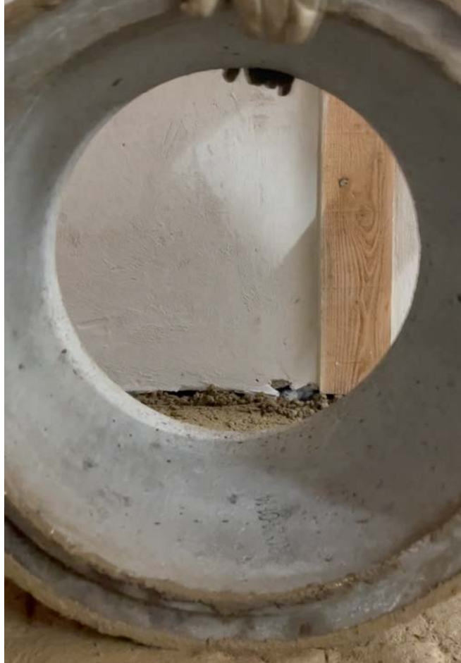
↑ Nederst tv: Jørn og Lasse spreder første lag lergulv Nederst th: Beton brøndring som erstatning for pladevibrator Fotos: Hedeskov
