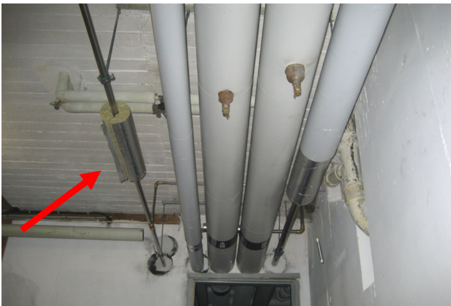
Figur B.3.2.3. Ekstra isolering af cirkulationsledning i kældergang.
