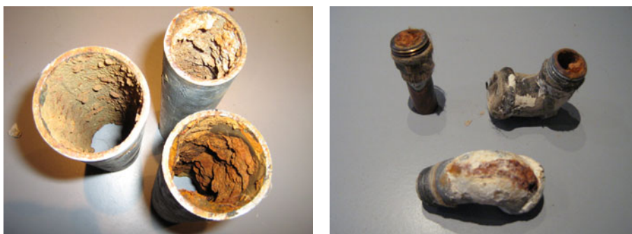
Figur 1.5.1. 40 år gamle vandrør. Tilkalkning (BK, BC,BV), tæring i bøjninger og samlinger. (Foto: Fyns almennyttige Boligselskab).
