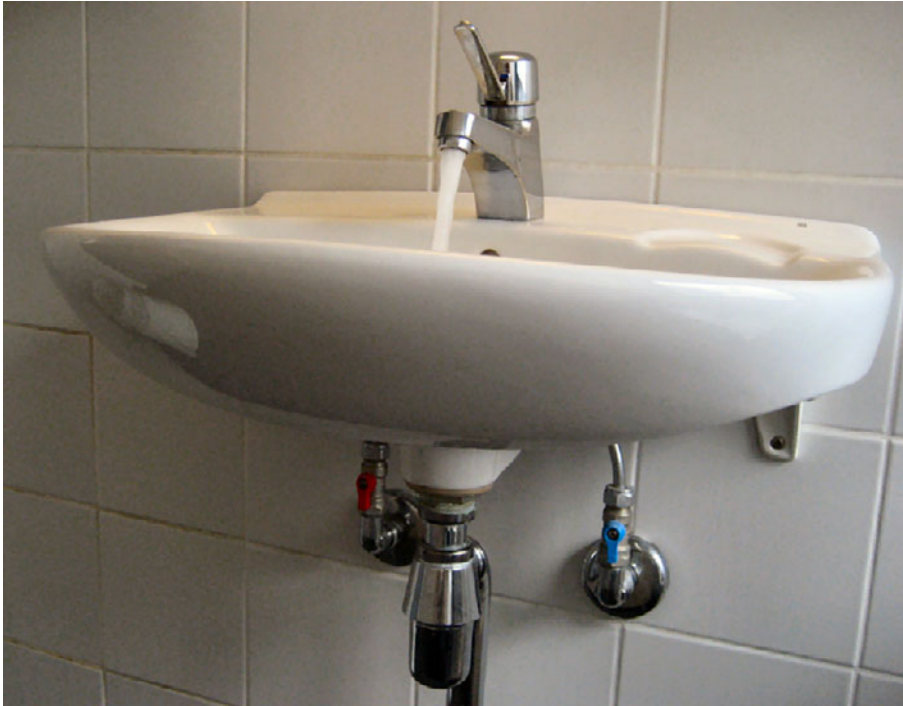
Figur 3.4.1. Ét-grebsarmatur ved håndvask. Armaturet tapper fra både koldt- og varmtvandskoblingsledningen.
