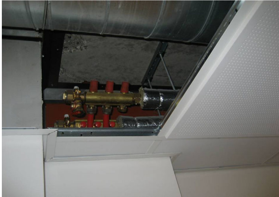
Figur 2.4.3. Uisolerede fordelerrør over loft.
