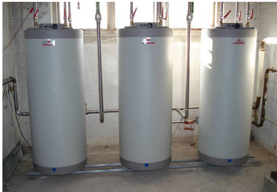
Figur B.3.1.3. Teknikrum med tre varmtvandsbeholdere..
