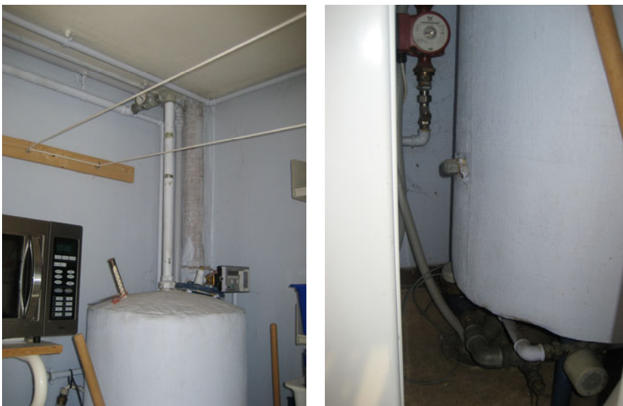
Figur B 2.9.2. Fotos af varmtvandsbeholder.
