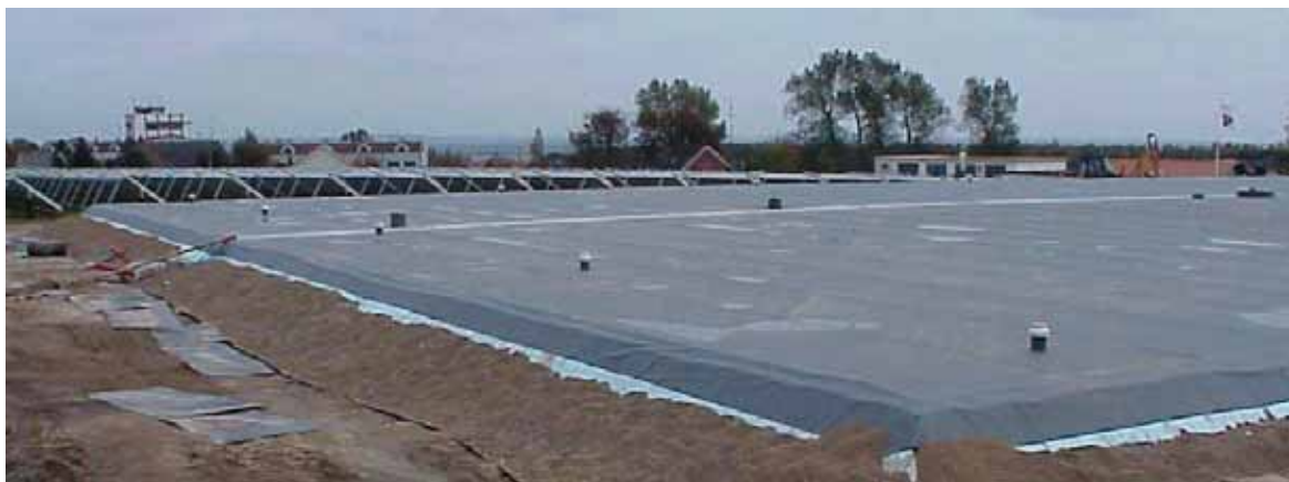
Foto: Marstal Fjernvarme
