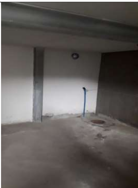
Billede 6: viser ventil i kælder under Kathale 2, hvorigennem der indsuges luft udefra
