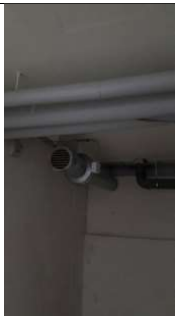
Billede 3: Viser udsugning i kælderende under Stjernskærm 6
