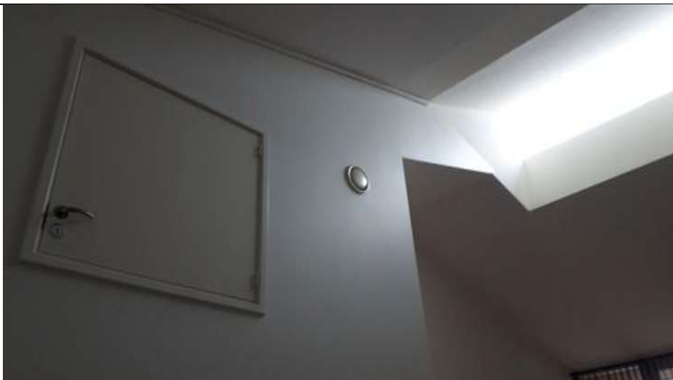
Billede 5: viser ventilationskanal til varme/luftveksler placeret på loft over beboelse (indgår i begge typer rækkehus). Billedet viser tillige ovenlysvinduesparti i loft samt indgang til loftrum med varmeveksler
