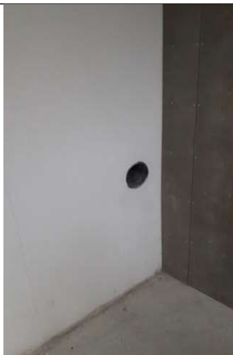
Billede 7: viser rørført (udsugnings) ventil fra kælder under Kathale 2 til den øvrige kælderregion. Enderegionen i denne kælder er ikke undersøgt for aktiv udsugning
