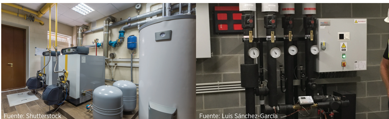
Fotografía 5 Calderas de gas en una sala de calderas de gas (izquierda) y una subestación en un edificio en Bélgica (derecha)
