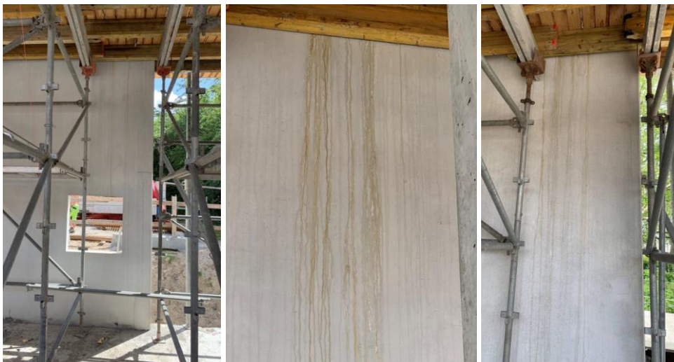
FIGUR 34. Rustløbere på ny beton.
