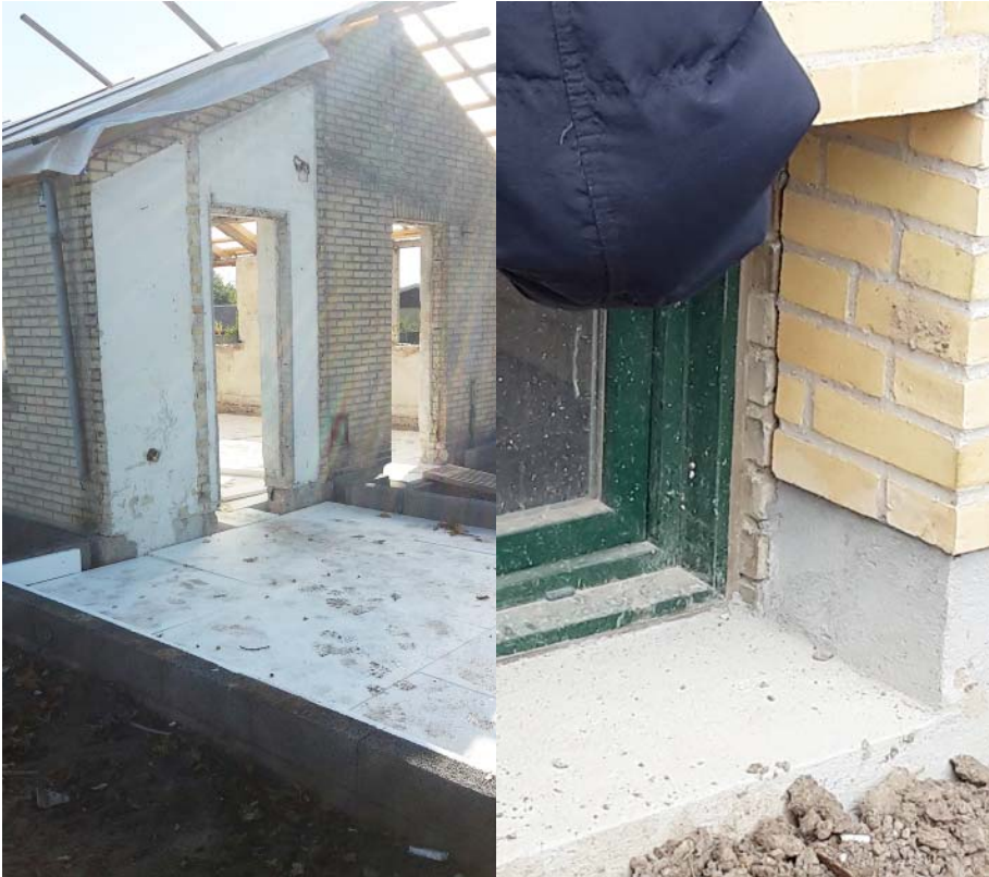
Feltfoto 21 og 22. Større eller mindre dele af konstruktionen er blevet skiftet ud. I billedet til højre kan man ane den oprindelige mur, inde bagved den 20 - 30 cm efterisolering.
