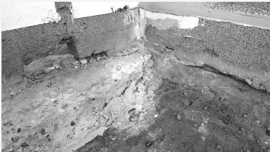
Feltfoto 5. Problemer med opstigende grundfugt er blevet afdækket i forbindelse med renoveringen.
