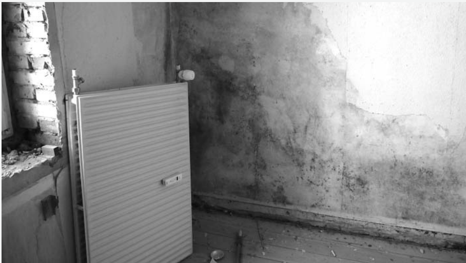
Feltfoto 13. Billedudsnit af bolig under renovering. Den nordvendte væg viste tydeligt spor efter fugtpåvirkning.
