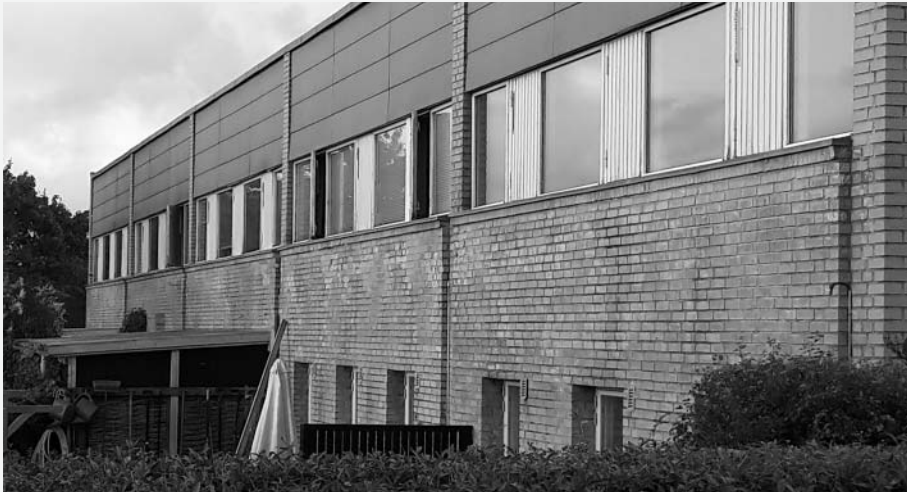
Feltfoto 3. Kombinationen af lette facadeelementer, frostsprængte cellesten og en byggeskade i tagkonstruktionen har forvoldt mange problemer i denne bebyggelse.
