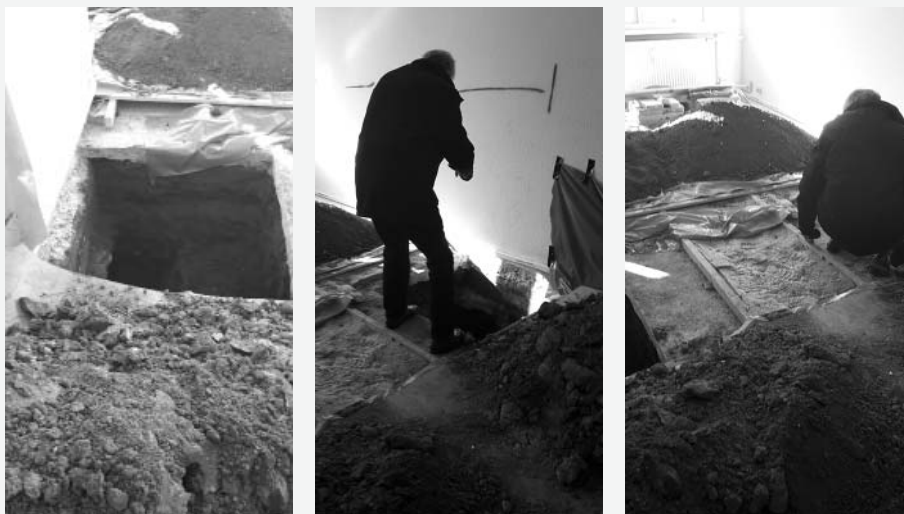
Feltfoto 7, 8 og 9. Omfattende udgravninger i forbindelse med de indledende undersøgelser: Hvor slaggermaterialet havde sunket sammen og suget fugt til sig og videre op i konstruktionen.
