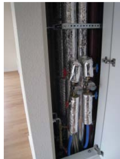
Figur 27. Etablering af individuel forbrugsmåling og -afregning (som her i Albertslund Nord) medfører erfaringsmæssigt store besparelser på varme- og vandregnskabet.
