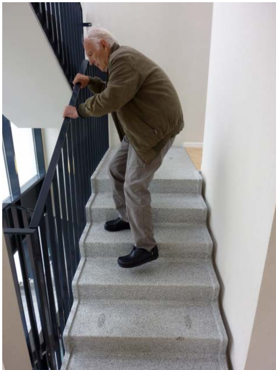
Figur 38. Manglende gribeegnede håndlister nedsætter sikkerheden på trapper.
