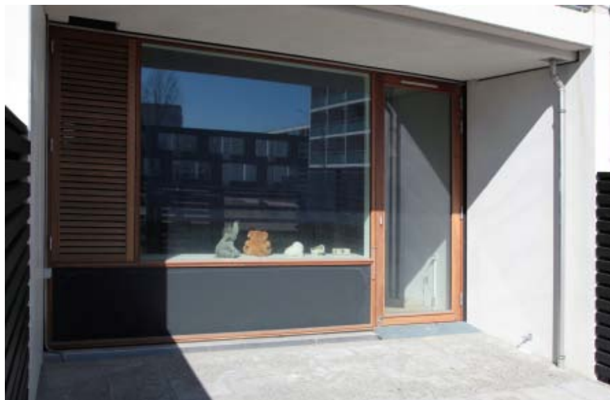
Figur 61. Fugtsikring med rende mellem terrasse og facade. Gitterristen bør udvides eller dække renden i hele terrassens bredde.
