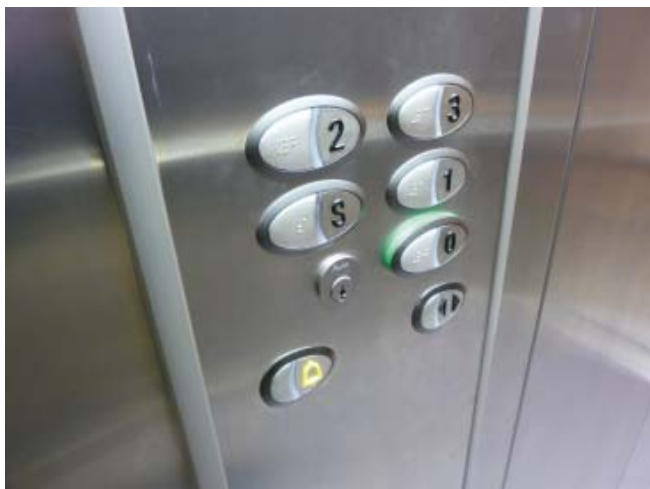
Figur 35. Eksempler på store, letgængende betjeningsknapper i elevator og løfteplatform.
