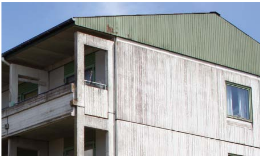
Figur 89. Bebyggelsen umiddelbart før den aktuelle renovering. Bebyggelsen var stærkt nedslidt.
