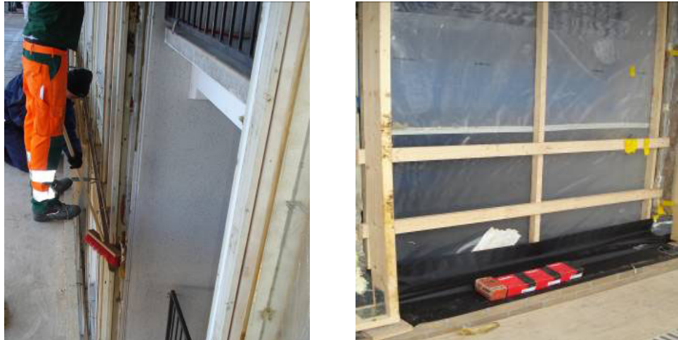
Figur 4. Eksempel på løsning udtænkt umiddelbart i forlængelse af sikkerhedsmøde: Afdækning af trappeopgang efter fjernelse af eksisterende vinduer. Efter fjernelse af de eksisterende vinduer opstod en åbning med stor risiko for faldulykker (billedet til venstre). Åbningen blev afdækket med en løsning alle parter kunne acceptere (billedet til højre).
