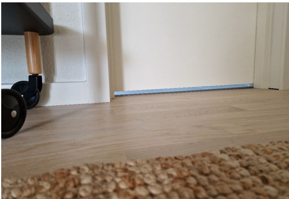
Figur 20. I tilgængelighedsboliger sikrer en luftspalte under døren, at luften bliver udskiftet i alle rum. Foto: Turid Borgestrand Øien.
